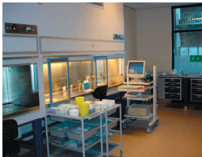
Bereidings ruimte radiofarmaca conform GMP.
